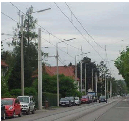
getrennte Beleuchtungs- und Fahrleitungsmaste Burenstraße
