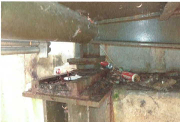
Brückenlager am Ufer: Funktionsfähig, mit Korrosionsschäden und verschmutzt
