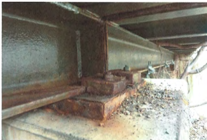
Untersicht Rampe rechter Uferbereich, Korrosionsschäden im Auflagerbereich
