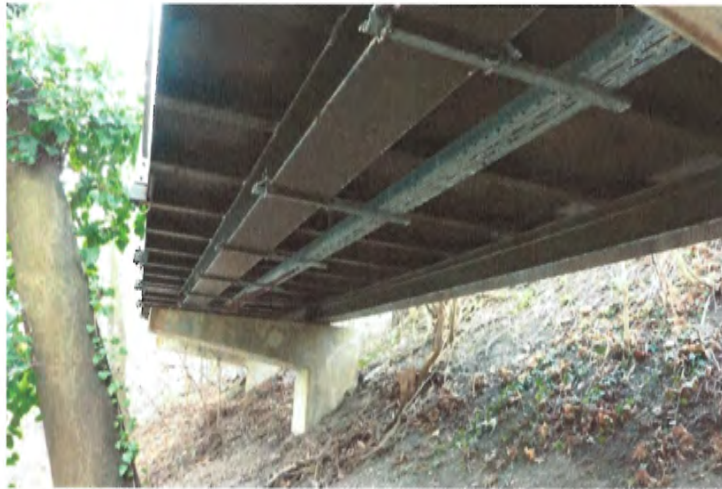
Untersicht Rampe rechter Uferbereich , Kabeltasse Korrosionsschäden
