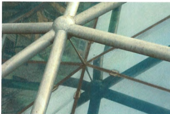
Glasverfugung im Bereich Cafe
