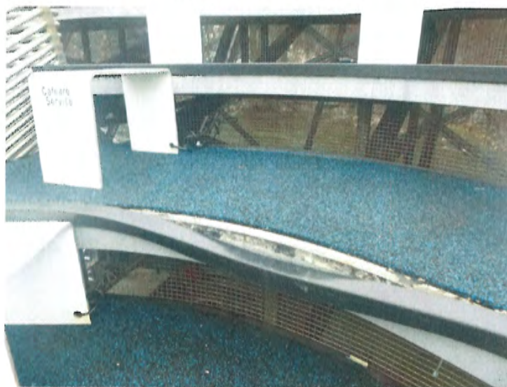
Belag Tribünen, loser Kantenschutz
