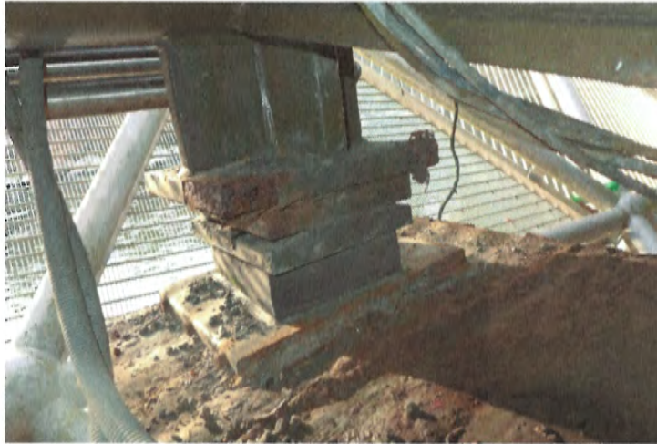
Brückenlager auf Insel: Funktionsfähig, mit Korrosionsschäden
