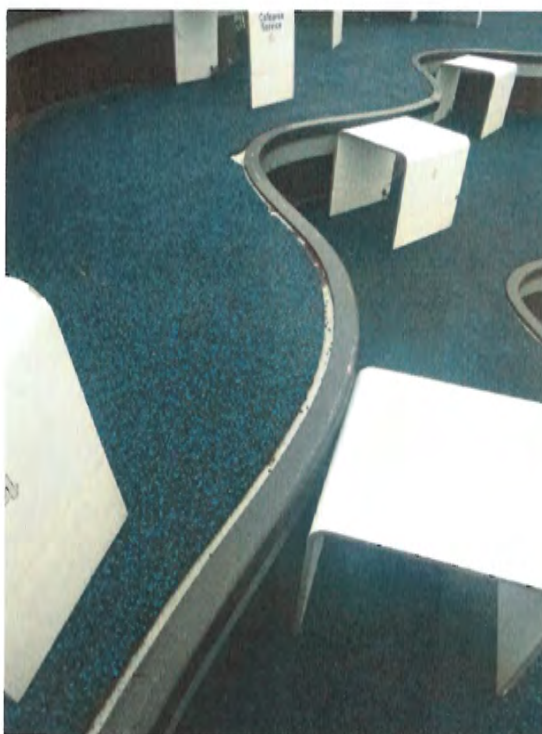
Belag Tribüne, Fehlstellen
