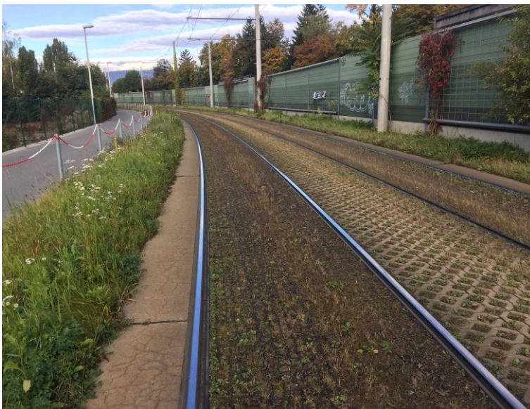
Foto 4: Graz Linie 4 Josef Huber Gasse, falscher Aufbau mit einer zu geringen Humusschicht, keine Beschattung
