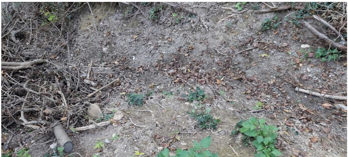
Abb. 9: Abrisskante und Erosionsrinne (nordwestlicher Grundstücksabschnitt)
