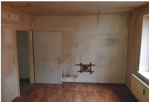
Abbildung 6: Brauchbarmachung – vorher © Wohnen Graz
