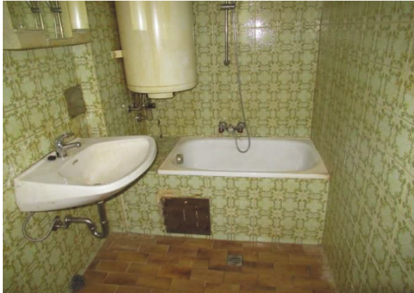
Abbildung 4: Badezimmer vor Brauchbarmachung © Wohnen Graz
