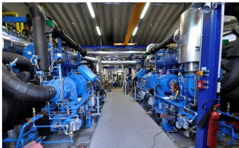
Abbildung 68: Wärmepumpenanlage in der Marienhütte Graz Quelle: Energie Graz GmbH & Co KG
