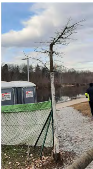
b) abgestorbenen Kronenpartien (hier bereits entfernt)
