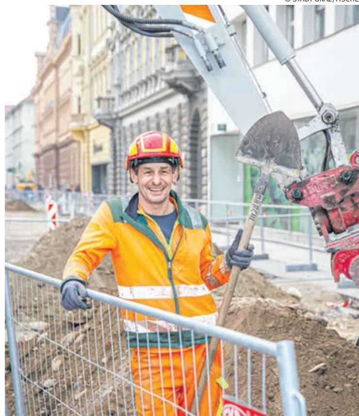
Auf- und Umbruch. Johannes ist einer der Arbeiter, die an der neuen Innenstadtentlastungsstrecke bauen.
